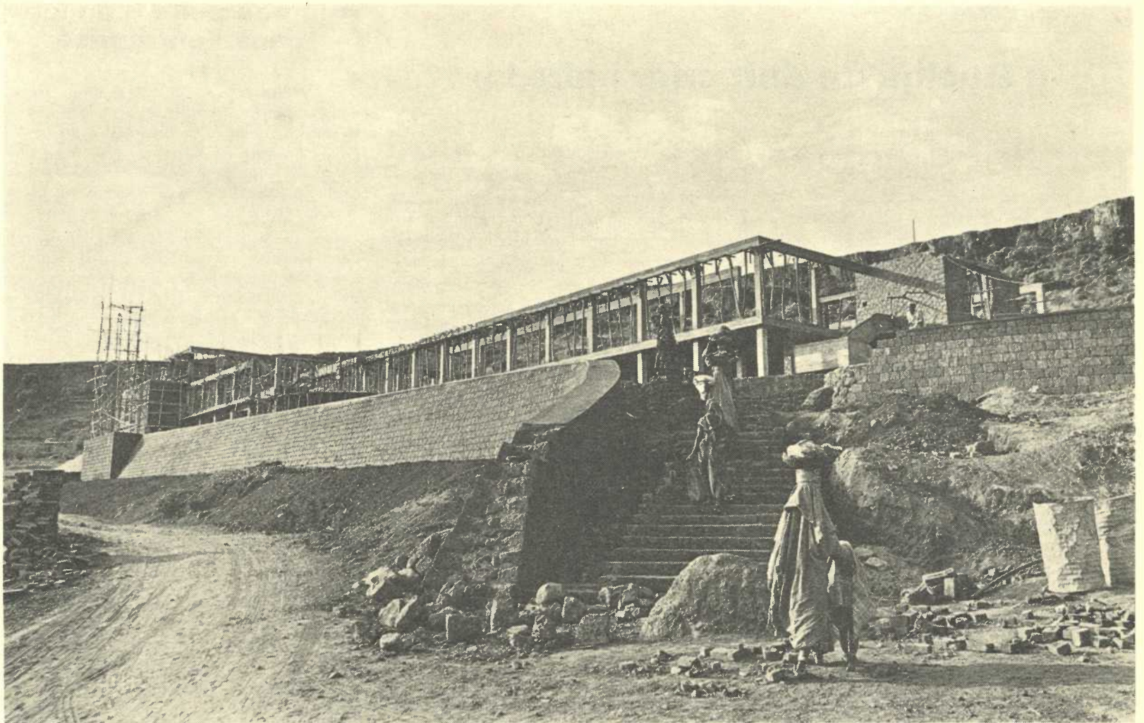
La construction du nouveau bâtiment : salle de conférences, auditorium, théâtre, salle à manger. Les travaux battent leur plein et seront achevés d'ici la fin de l'année. Leur inauguration est prévue pour le début de 1972.
